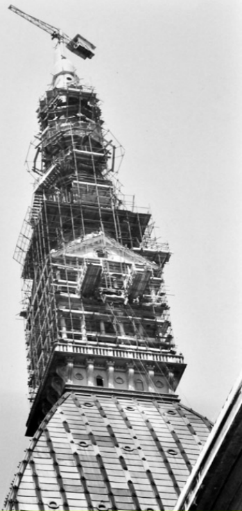
Lavori sulla guglia della Mole Antonelliana di Torino. 1961 Archivio di Stato, Torino
